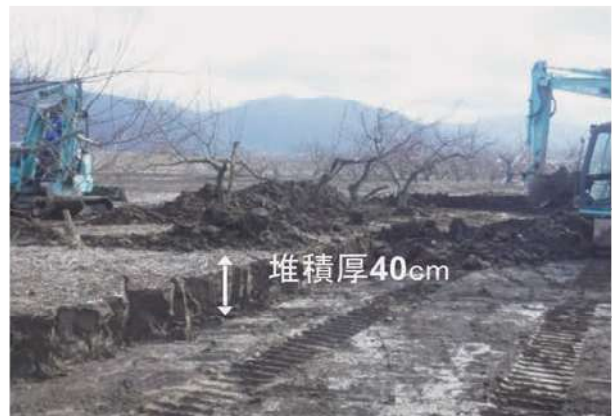
千曲川沿いの果樹園の土砂撤去（須坂市）
